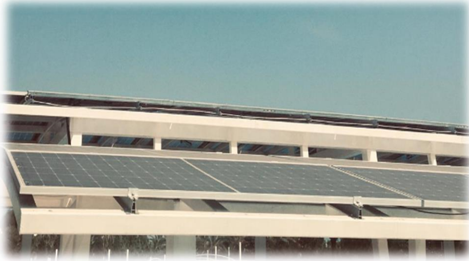
Havuz bölgesindeki panellerimiz
